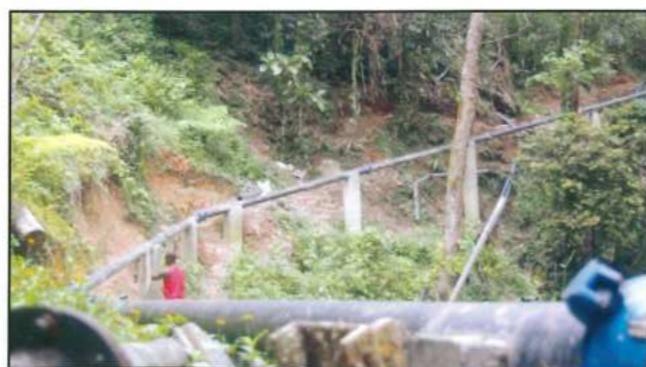
La conduite au départ du captage de Mia
