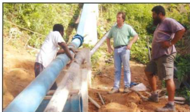
A gauche, la conduite qui desservira La Crouen et Haouli, et à droite la conduite de distribution de Emma
