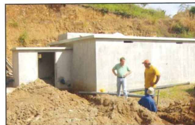
Branchement du bassin de Mia
